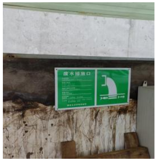
生活污水排放口
