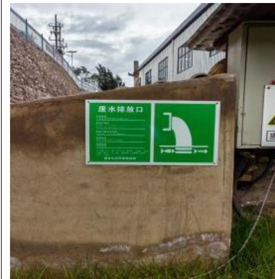
生产废水排放口
